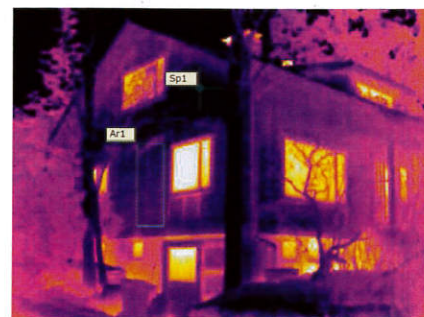
Omakotitalon energiatehokkuuden suunnitelmallinen parantaminen vaatii paljon erilaisia selvityksiä. Lämpökuvauus auttaa korjausten priorisoinnissa.
